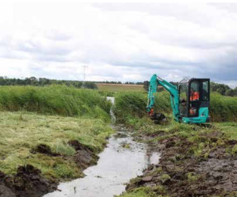
___ Großer Wotig: Nach Instandsetzung der Abflussbahnen füllten diese sich diese sofort mit Wasser. Foto: Johannes Limberg 03.08.2021.
